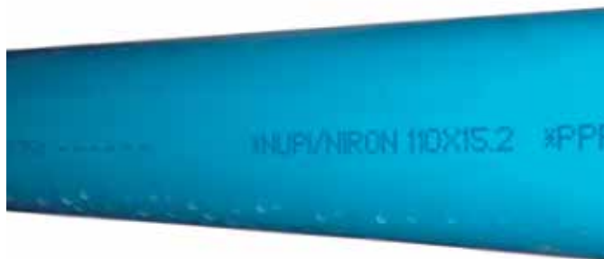
Estado de tubería NIRON con condensación superficial.
