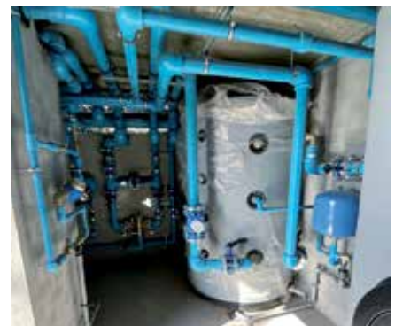
Sistemas de agua caliente.
