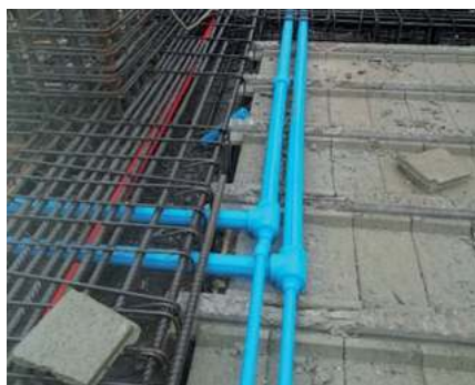
Tuberías empotradas en losa.
