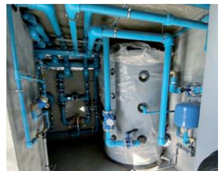
Sistemas de agua caliente.
