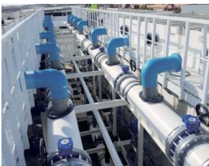
Sistemas de condensación.
