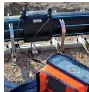
Distribución agua en zona
