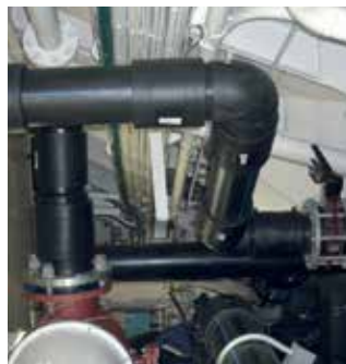
Tratamiento de aguas en buques
