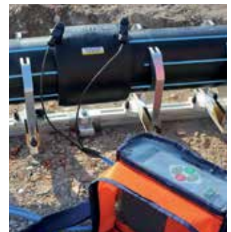
Distribución agua en zona portuaria
